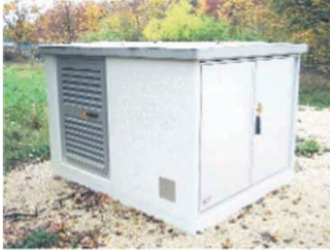
Şek.10.17 Kent sokak ve yeşil alanlarındaki trafolara bir örnek
